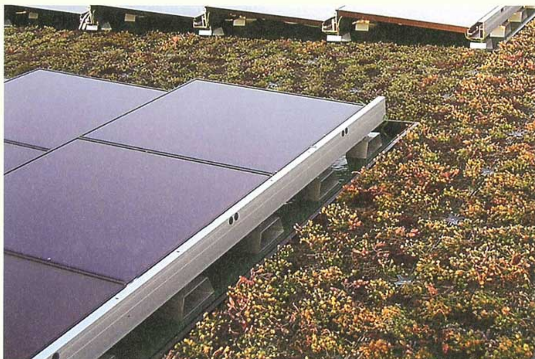
◇工場厚生棟(緑化PV)
